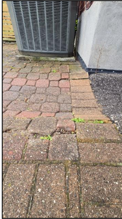
16. Uneven (trip hazard)
